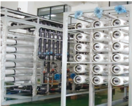
电厂脱盐水RO系统
