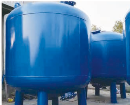
机械过滤器、活性炭过滤器
